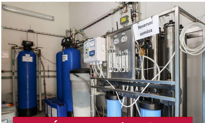
Úpravna vody, RO
